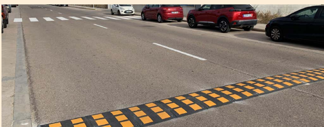
Colocación de badenes reductores de velocidad y pintado de pasos de cebra en diversos puntos.
