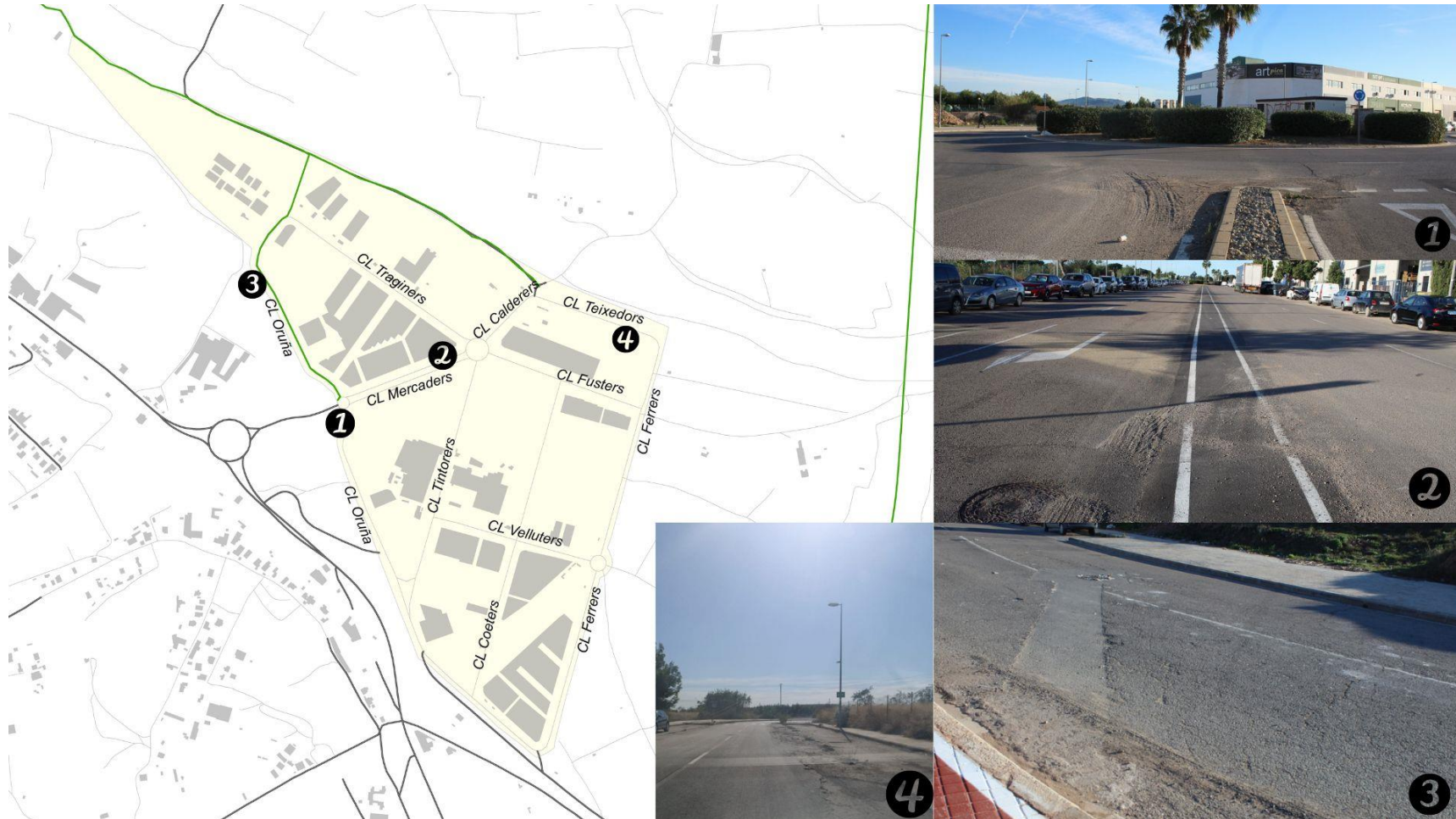
Imagen 8. Presencia de grietas en la calzada del PI Horta Vella
