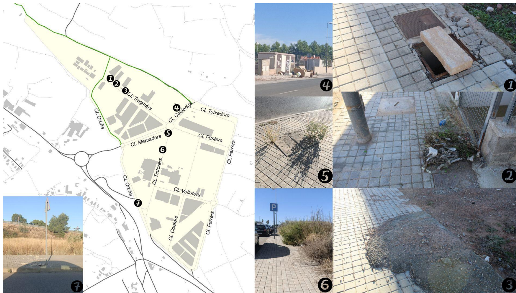
Imagen 9. Acerado dañado o invadido por vegetación
